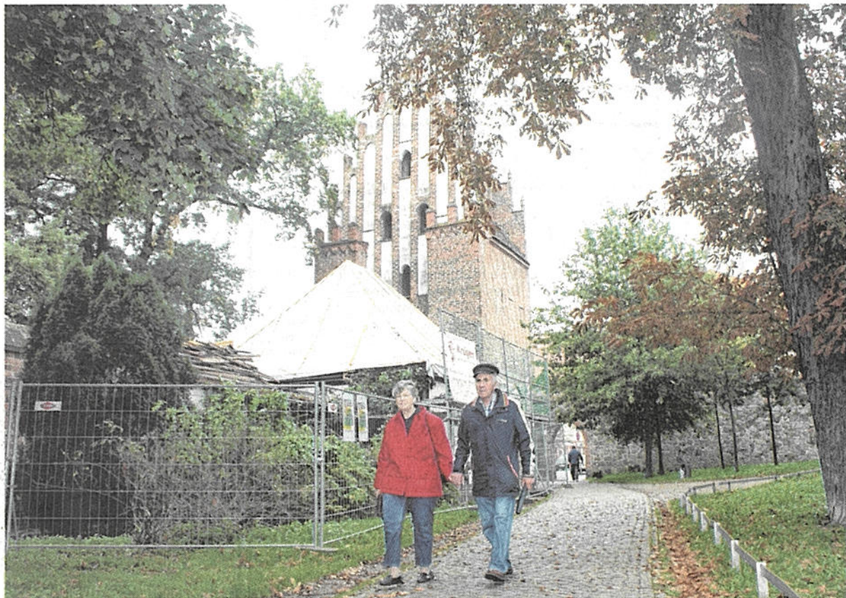
Das Zollhaus im Stargarder Tor wird derzeit saniert. Das Dach muss neu gedeckt werden.
